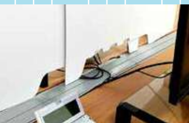
配線スペース
