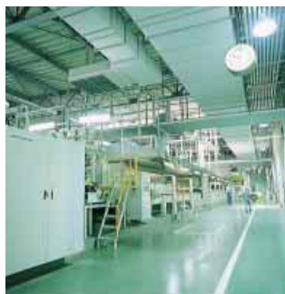
段ボール製造設備
